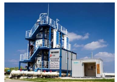
（沖縄県の100kW級海洋温度差発電実証プラント）
